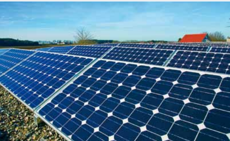
Photovoltaikanlage auf dem Dach der Buchbinderei.
