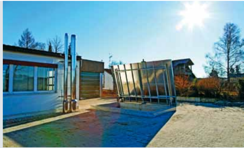
Außenansicht von Kamin und geöffnetem Vorratsraum für die Hackschnitzel. In die abgebildete Luke können die per Container angelieferten Hackschnitzel eingeschüttet werden.
