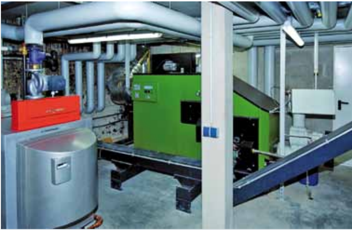
Heizraum mit dem Hackschnitzelofen (grün) und einem Gas-Brennwertkessel für die Spitzenwertabdeckung und Redundanz.
